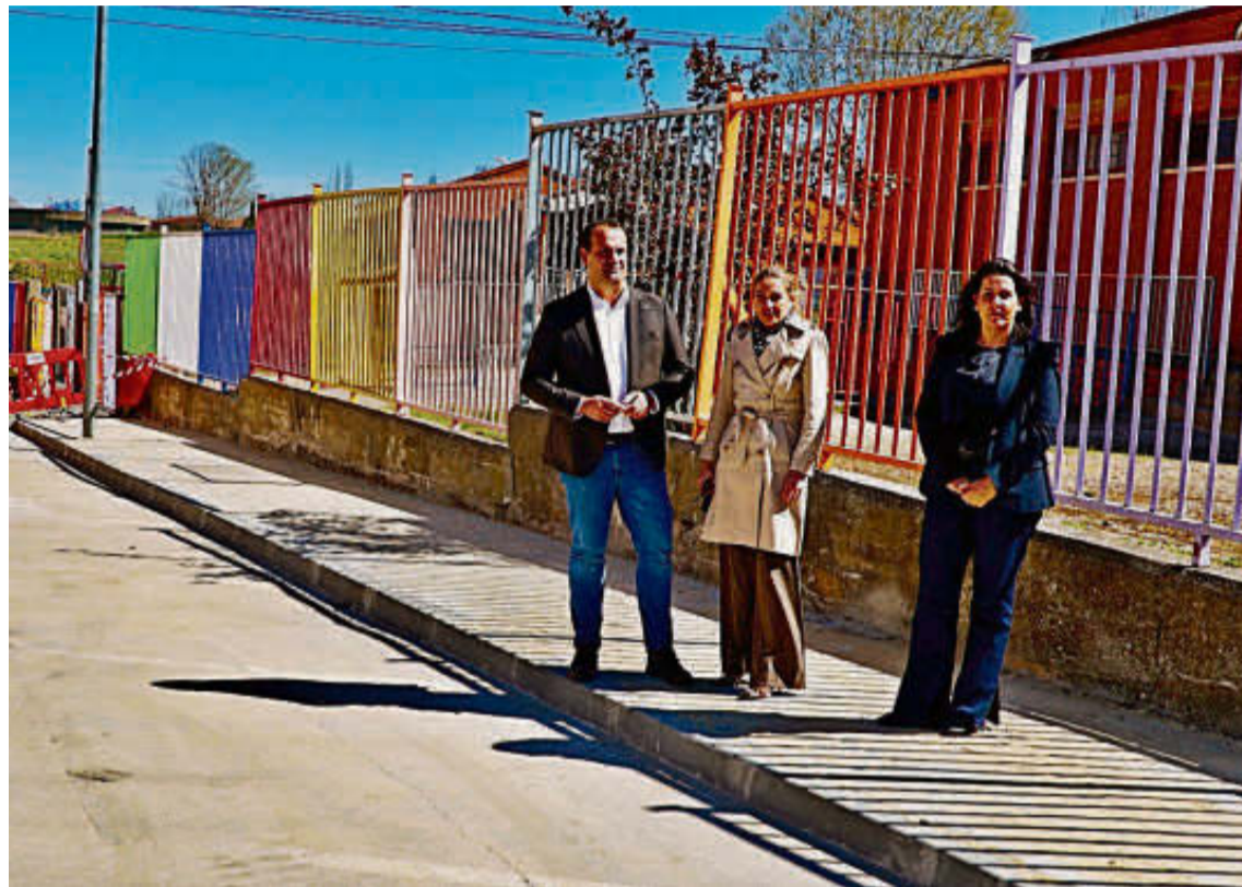
David Mingo, Marta Labrador y Silvia González en la zona en obras de la calle Unicef. EÑE
