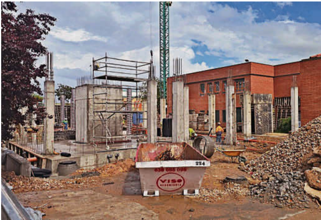
La construcción del edificio para albergar a los alumnos de la ESO llega a la primera de sus tres plantas. EÑE
