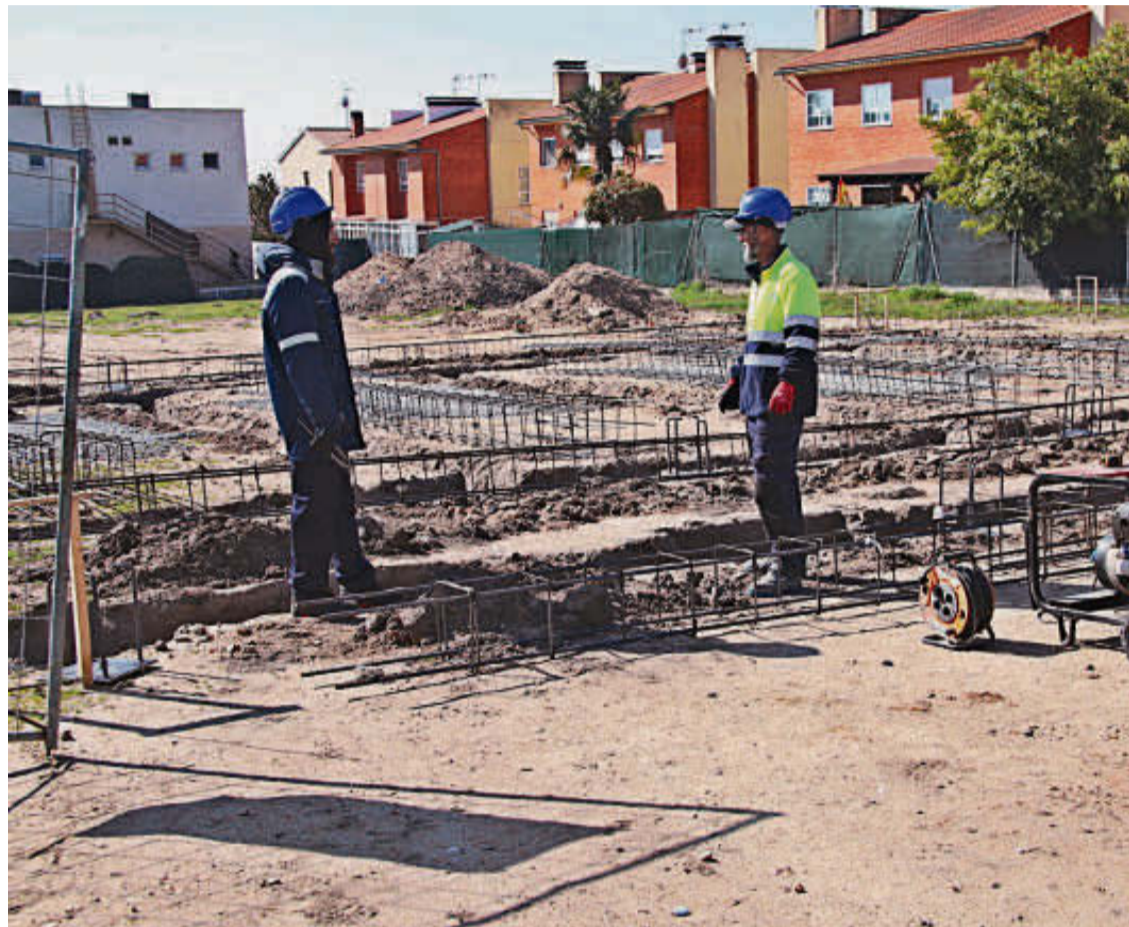
Operarios en el inicio de la obra del nuevo multiusos municipal de Cabrerizos. EÑE
