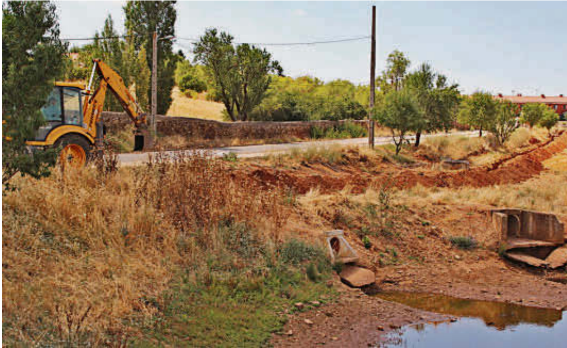
Maquinaria trabajando en el ensanchamiento de la tubería que da agua al municipio. EÑE
