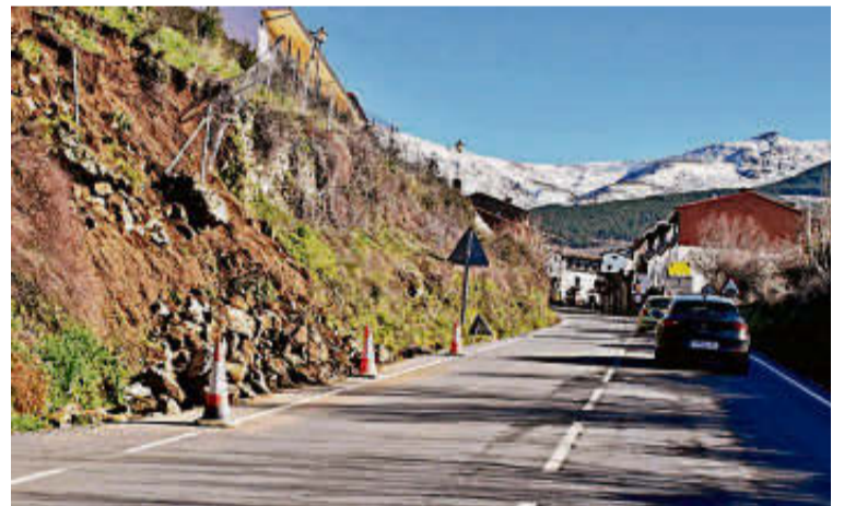
Desprendimiento en la carretera de acceso a Candelario. FOTOS:TEL
