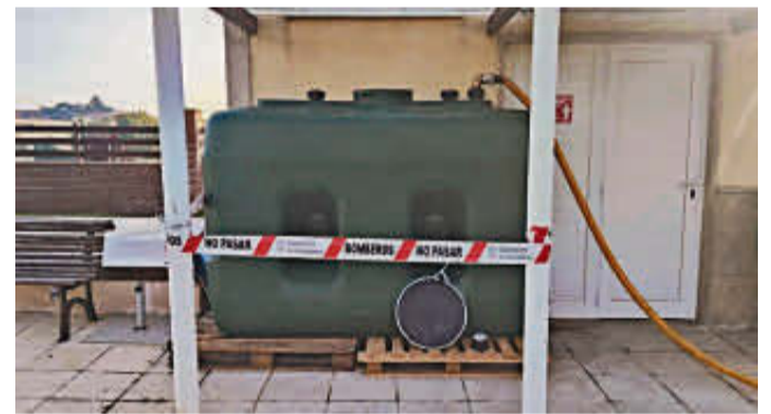
El depósito instalado por Diputación en auxilio del municipio. EÑE
