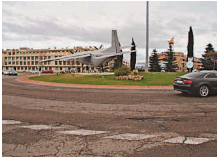
El pavimento de la rotonda de Matacán presenta defectos. EÑE
