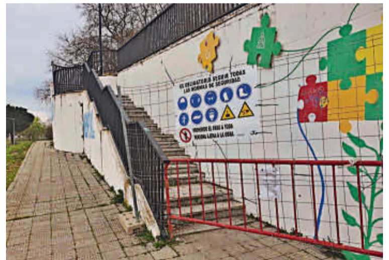
La pasarela peatonal de La Fontana permanece cerrada al paso.
