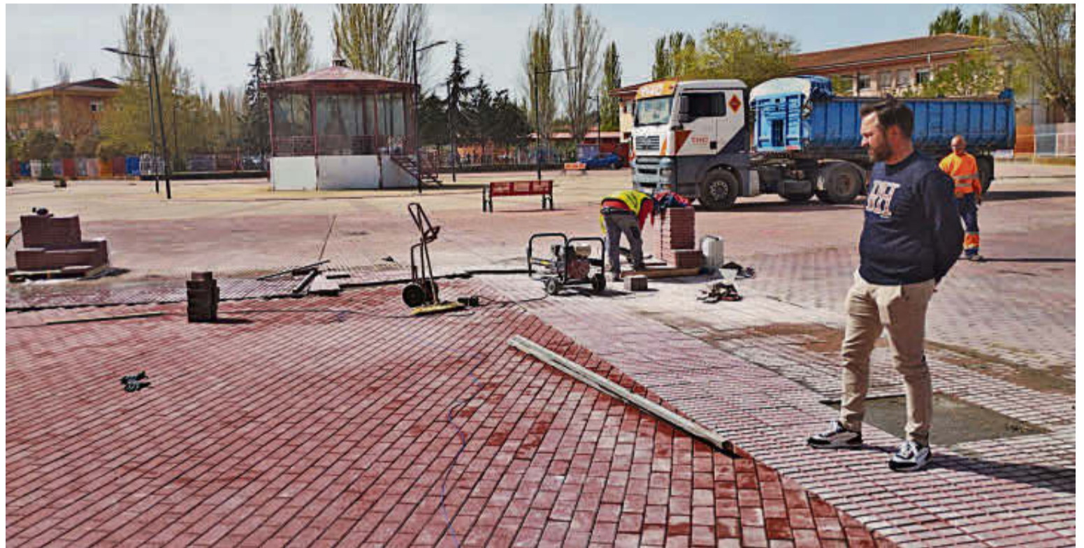
El concejal Norberto Flores en las obras de la ampliación de la plaza Tierno Galván. EÑE
