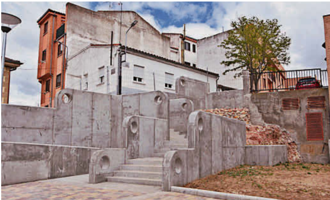
Las escaleras, sin barandilla, de las calles Sur y Laguna de Carbajosa de la Sagrada. EÑE
