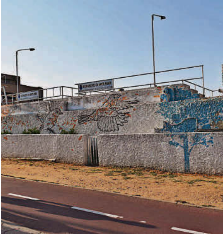
Actual estado de la antigua depuradora de Santa Marta. EÑE
