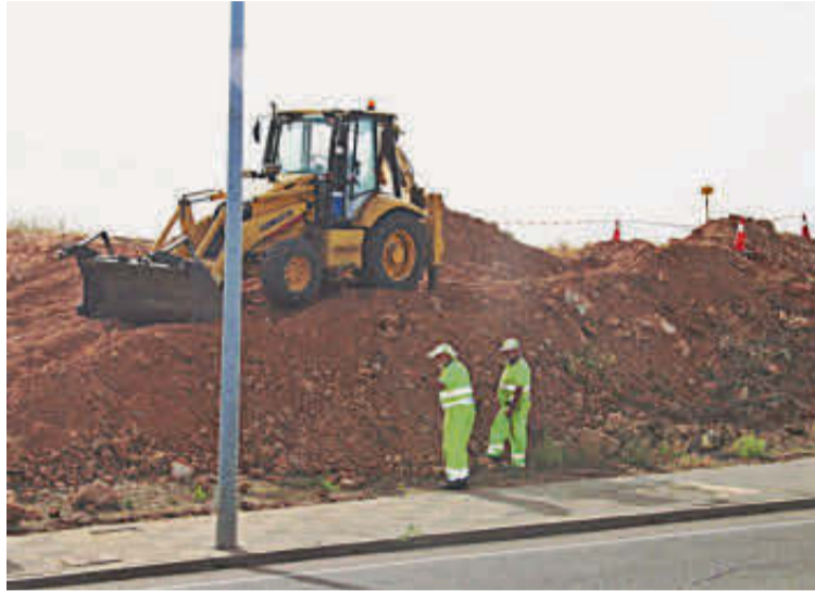
Los operarios en el inicio de la obra del carril bici desde Villamayor. EÑE
