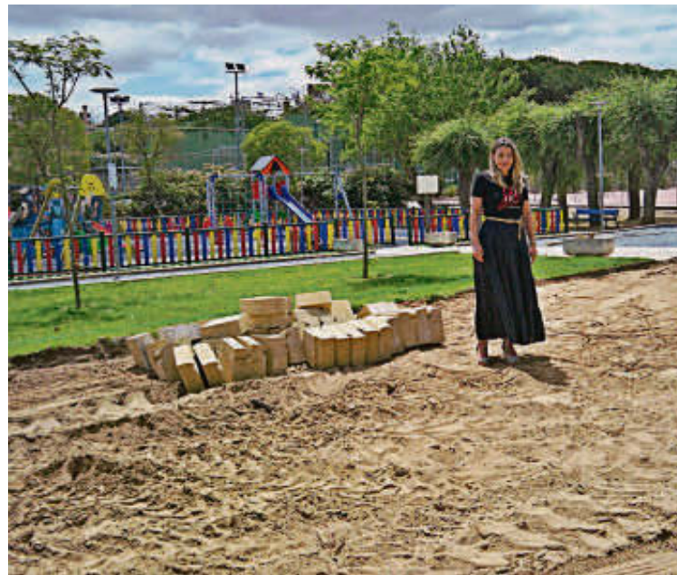
La edil de Obras, Marta Labrador, en la mejora para Valdelagua. | EÑE
