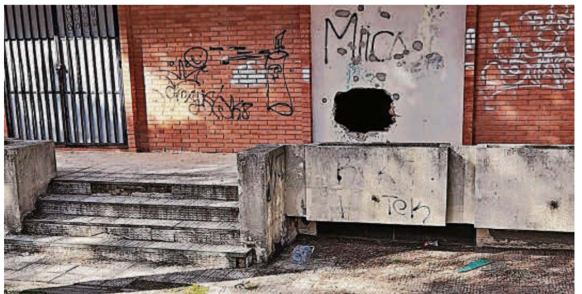
El agujero de gran tamaño hecho por los vándalos para acceder al edificio de la antigua piscina de Los Cisnes. | EÑE
