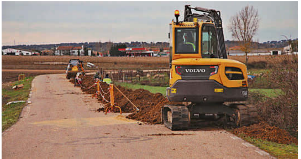
La maquinaria pesada que está instalando la canalización para llevar la red de agua a Mozodiel. EÑE
