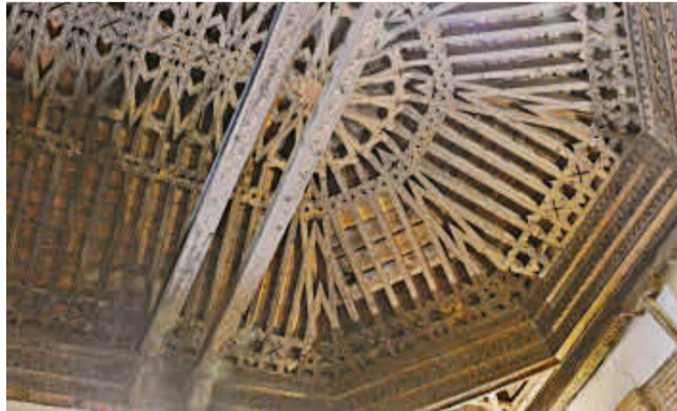
Estado de deterioro que presenta el artesanado de la iglesia.
