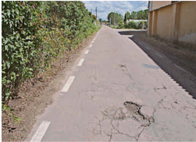
El estado deteriorado, con baches y grietas, del asfalto de la calle. EÑE
