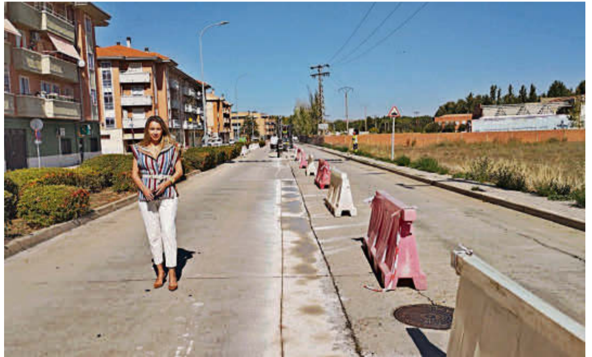
La edil de Fomento, Marta Labrador, en el punto en el que ha comenzado la renovación de tuberías. EÑE
