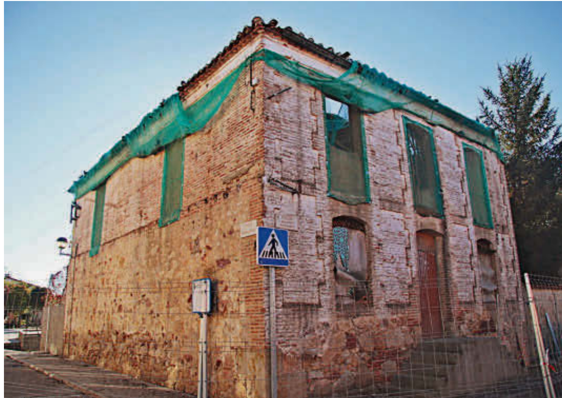
El estado actual del edificio de La Panera en Monterrubio de Armuña. EÑE
