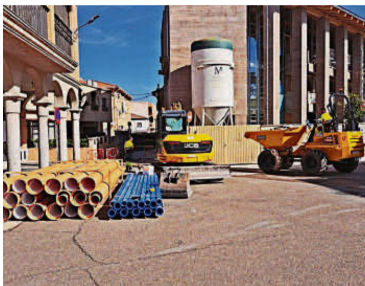
La obra de renovación de tuberías en la Plaza Mayor de Carbajosa. EÑE
