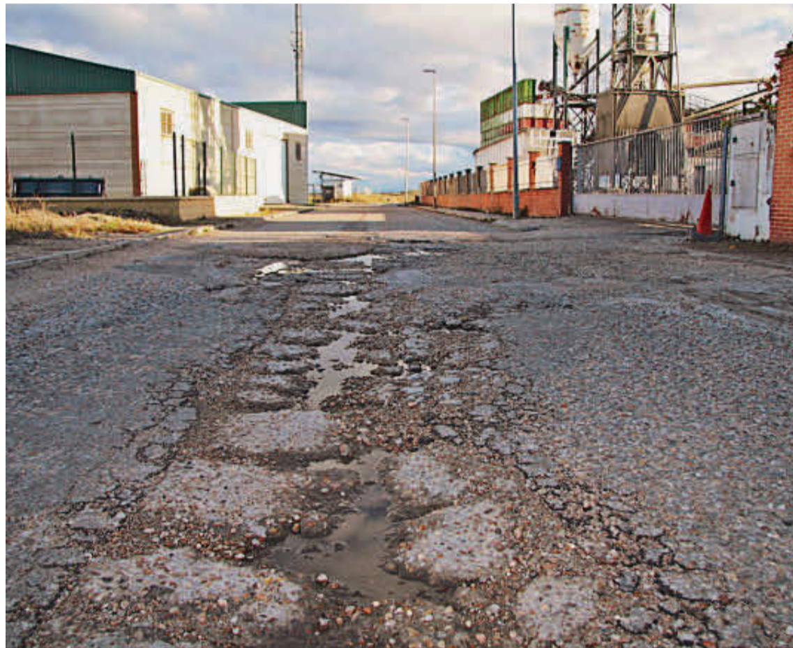
El estado del pavimento de las calles más antiguas del polígono de Castellanos de Moriscos. EÑE
