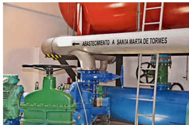
Mecanismo a través del cual se conduce el agua a Santa Marta. EÑE
