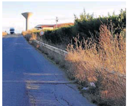
Firme en mal estado y arbustos que tapan las señales. :: WORD
