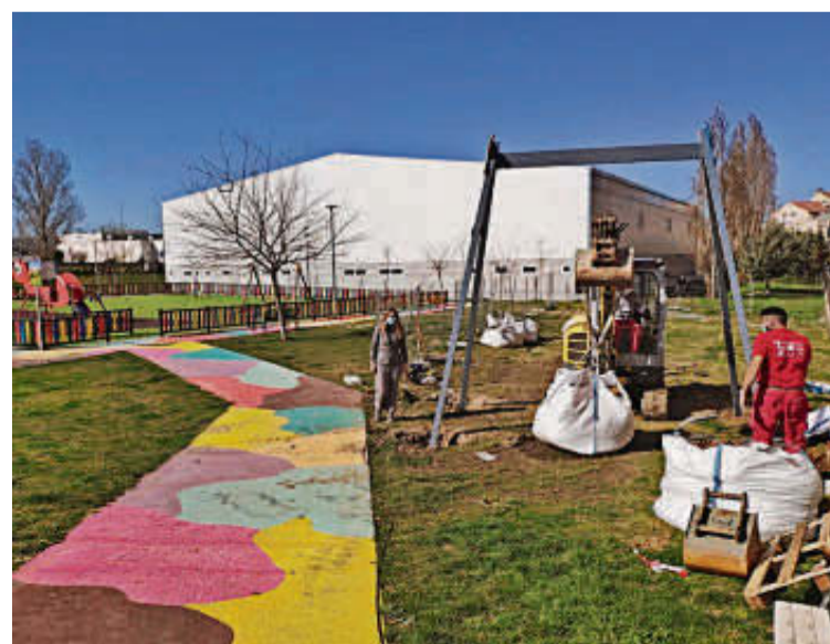
Las obras de colocación de la nueva tirolina en la avenida de Valladolid. | EÑE
