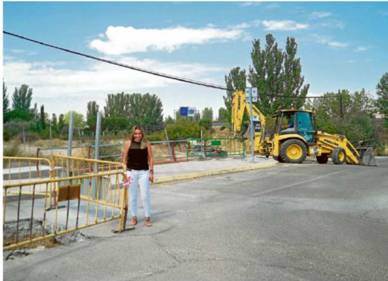
La concejala de Obras y Servicios, Marta Labrador, conoció el estado final de las obras de la nueva tubería. | EÑE
