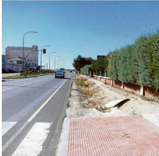
El tramo del paseo de Las Delicias a urbanizar en los próximos días. | EÑE
