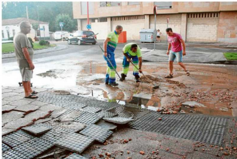
Operarios municipales y de la empresa Aqualia trabajan en la zona donde se produjo el reventón. | FOTOS:ENE
