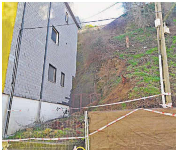
Estado del talud después de las intensas lluvias de principios de semana. | TEL
