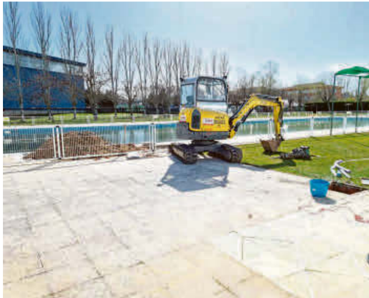
El inicio de las obras de reparación en la piscina de Santa Marta. | EÑE
