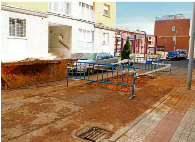
La calle Ciudad de León, una de las más afectadas por los reventones debido a la antigüedad de la red. | EÑE
