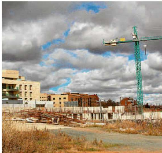
Obras de las nuevas viviendas en el sector de acceso al municipio. | EÑE
