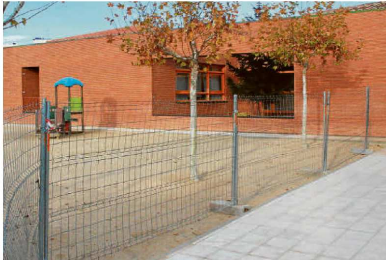
La Junta ha procedido a vallar dos patios para evitar riesgos y las paredes mantienen las bandas de sujeción. | ENE
