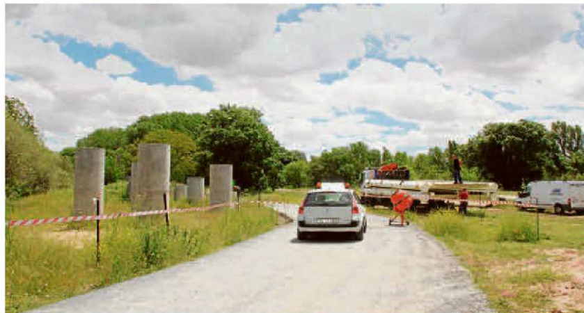
Un camión especial trasladó las primeras placas de la nueva pasarela peatonal de la Isla del Soto. | EÑE
